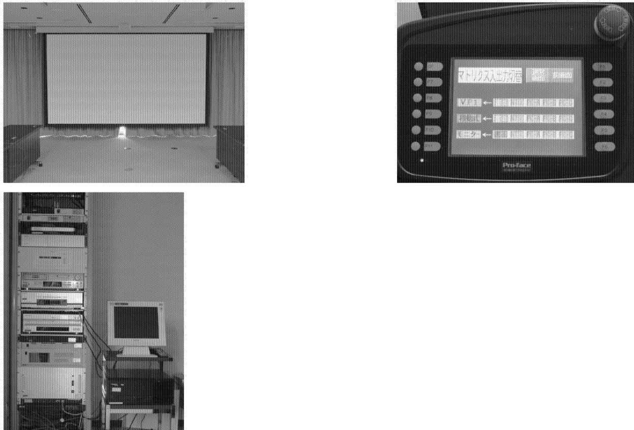
図 7 コラボレーションルーム 3 既存設備
