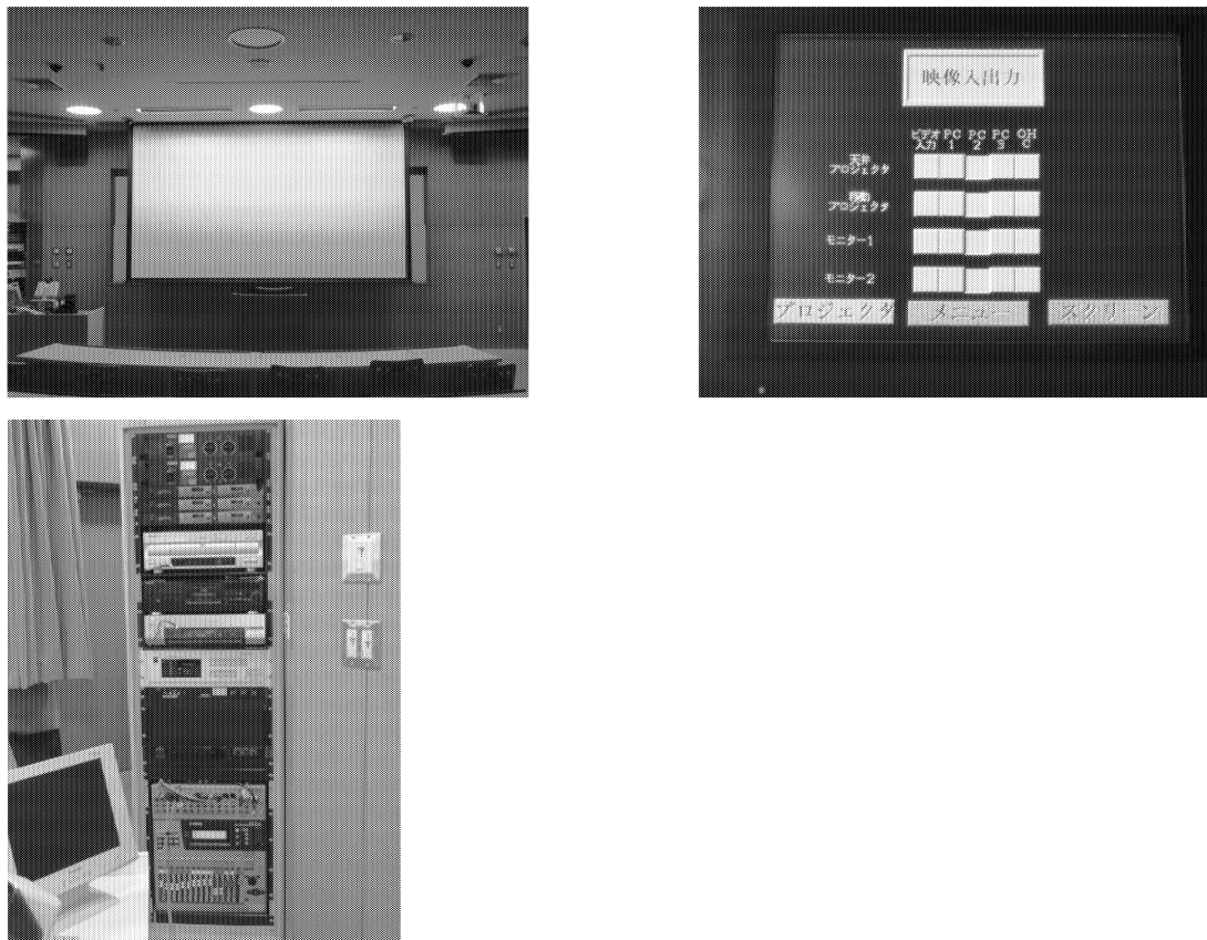
図 1 中講義室 既存設備
