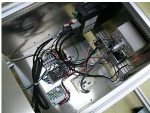
図 2. ターンテーブル制御盤内部
