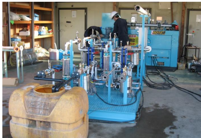
図 43 菓子残渣由来のエタノールを利用した発電設備の設置風景（筆者撮影）
