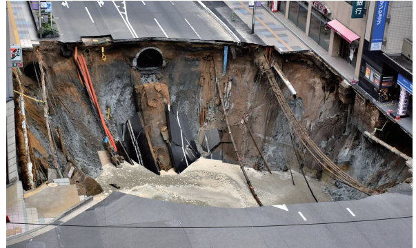
図8 博多駅前陥没（2016年11月）
