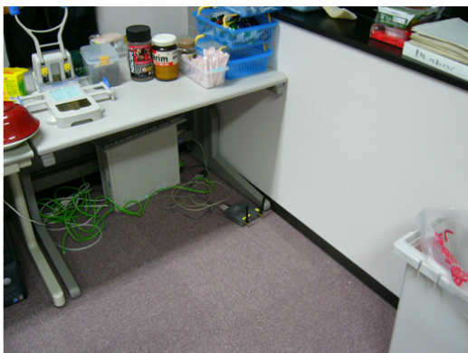
e: 机の下に設置
