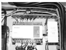
回収用圧縮機制御シーケンサー
