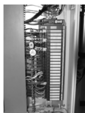
ヘリウム液化機電源盤PLC
