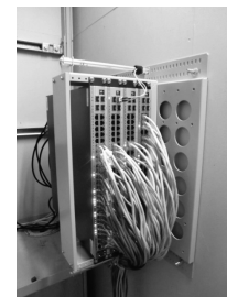
壁掛けラックにマウントされた4台のDGS3400
