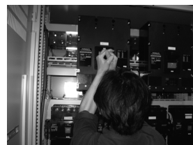
無停電電源装置(情報棟)
